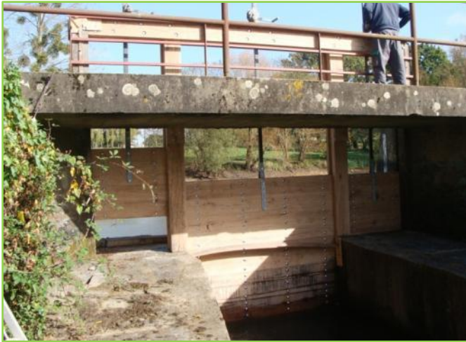
Les nouvelles vannes de la Fleuriais.
