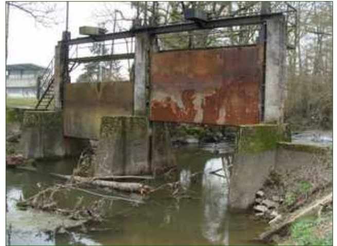
Vue des vannes à l'abandon
